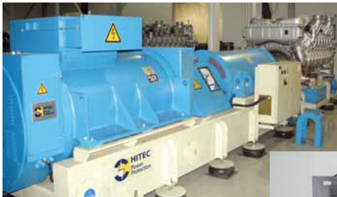
Voici une des génératrices permettant à HyperTec d'assurer l'autonomie de ses installations
